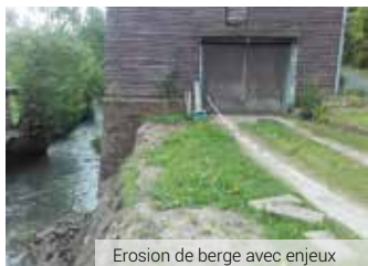
Erosion de berge avec enjeux
